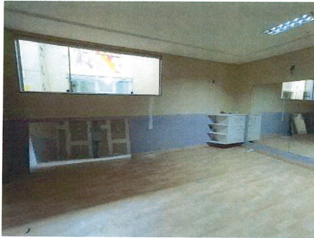
Sala I – 1 (um) armário embutido, 1 (uma) janela, 3 (três) luminárias, 2 (dois) ventiladores, piso emborrachado e 1 (uma) porta
