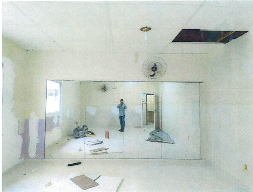
Sala E – 1 (uma) porta, 1 (uma) luminária, 2 (dois) ventiladores, 1 (uma) janela, espelho em toda parede frontal e teto reformados até a data da entrega.
